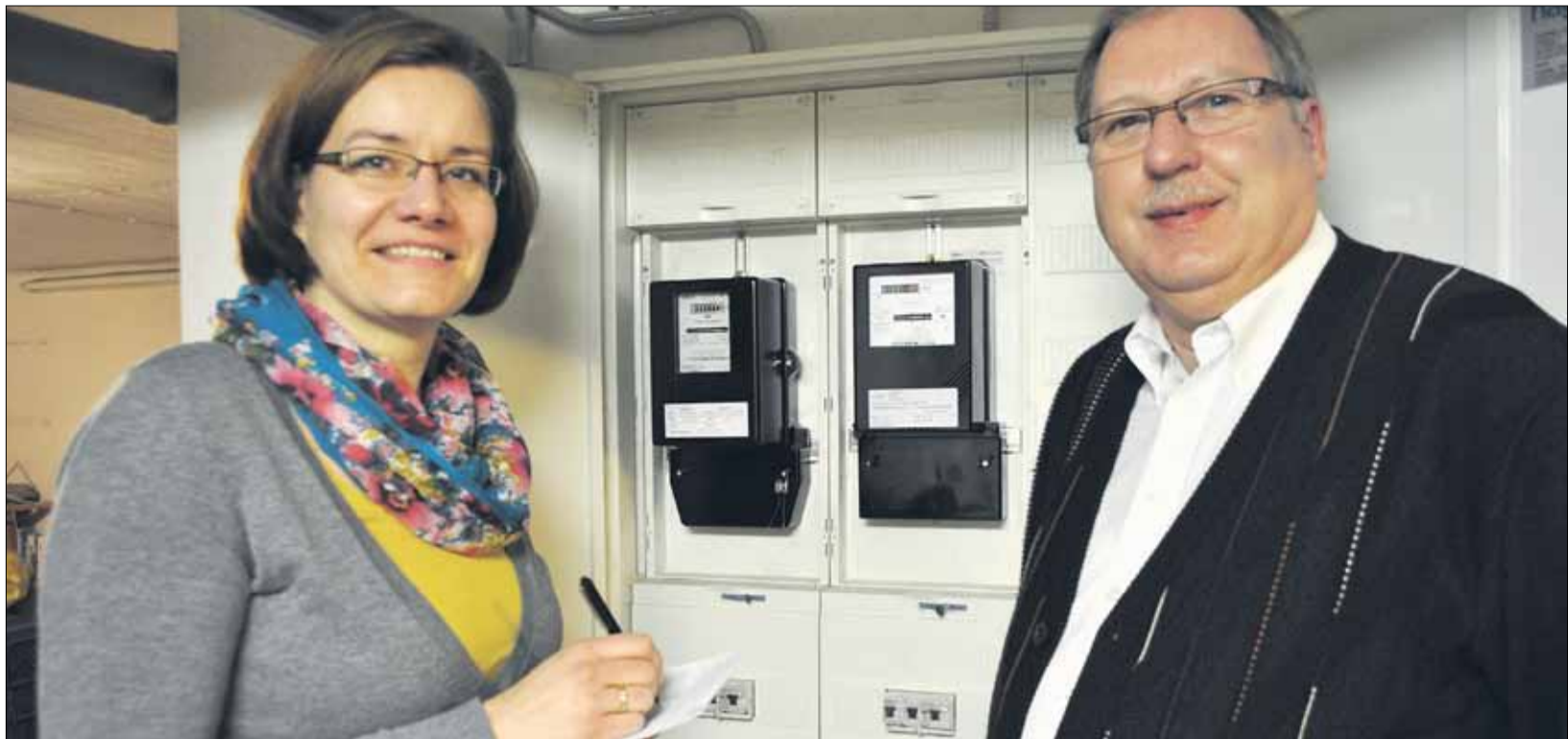
Rendantin Karin Köbbe und Pfarrer Heiner Mühlhäuser vor den Stromzählern im Keller des Pfarrhauses. Hier werden der Verbrauch für das Pfarrbüro und der Verbrauch für die Pfarrerswohnung getrennt erfasst. Foto: Andrea Kolhoff
